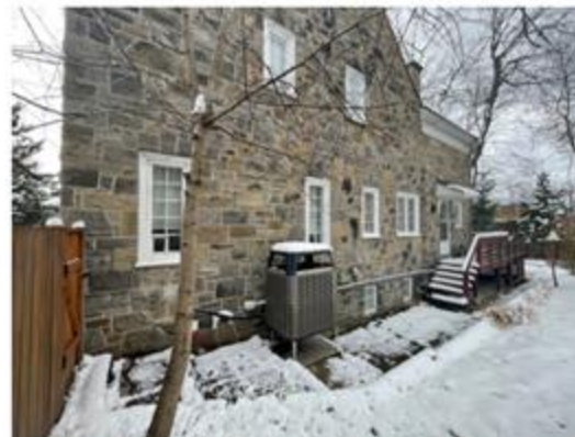
Démolition et reconstruction du balcon d'entrée arrimé avec nouveau paysagement du parvis
